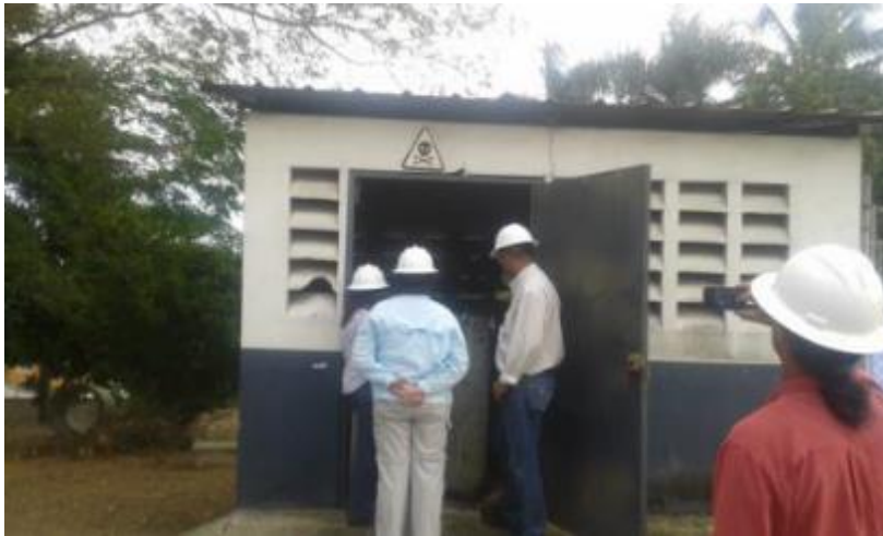
Figura 48 Punto Verde en Subestación Km 10 ½ de la Autopista Duarte, en EDESUR.
